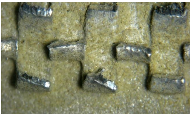
Ablagerungen in einem Kühlmittelkühler
